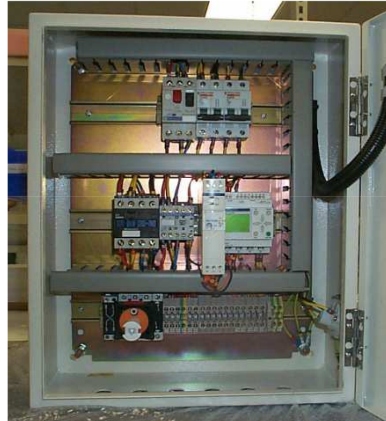
Panel menggunakan PLC
