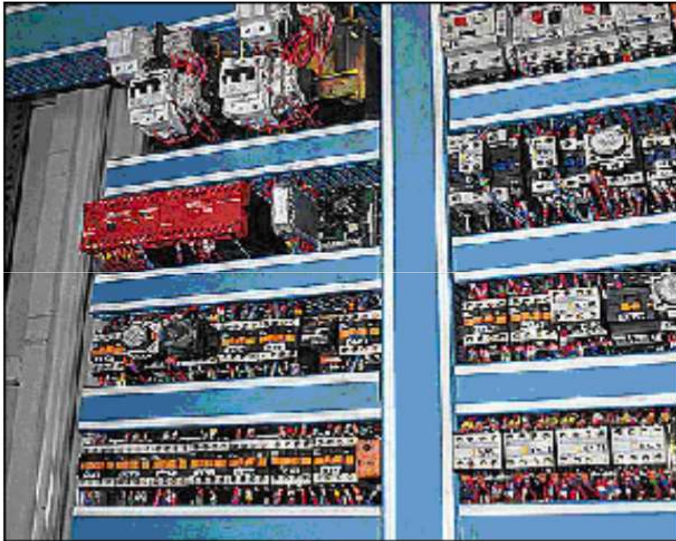
Panel sebelum menggunakan PLC
